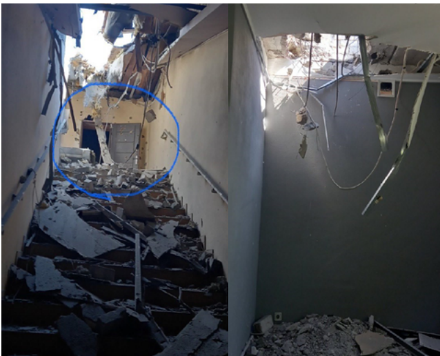
Вхід до офісу ГО “Ресурсний центр ВОЛНА-Донбас”, зруйнований російськими ракетами
